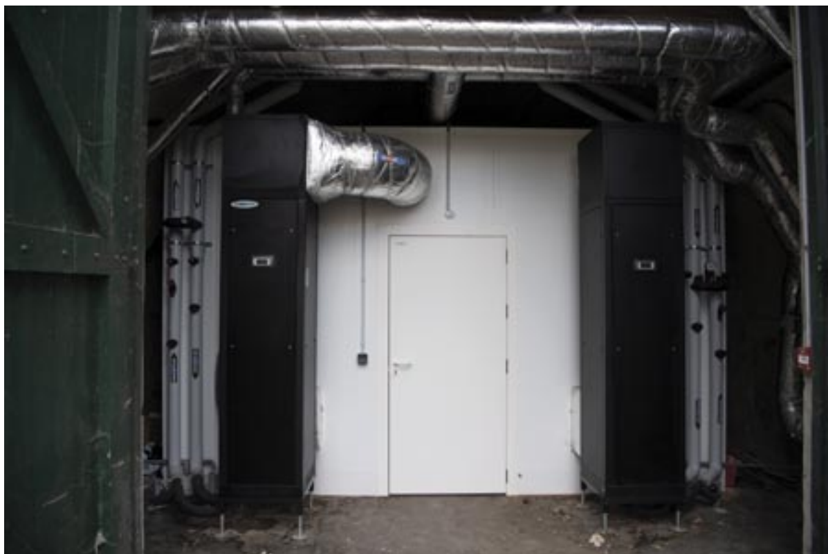
18 juin 2020. La casemate 16 du fort d'Ivry a été équipée d'un système de ventilation et de climatisation adapté à la conservation des cassettes vidéo.
