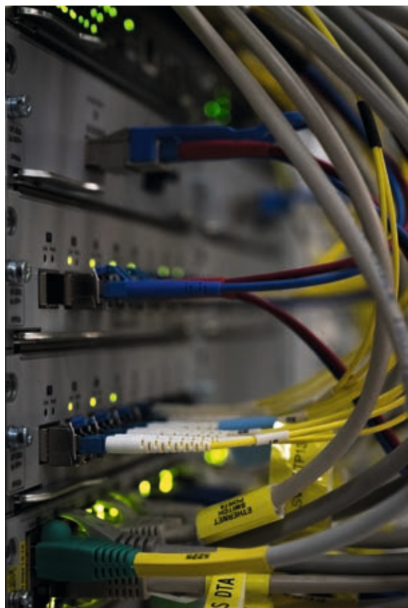
Dans la salle des serveurs.
